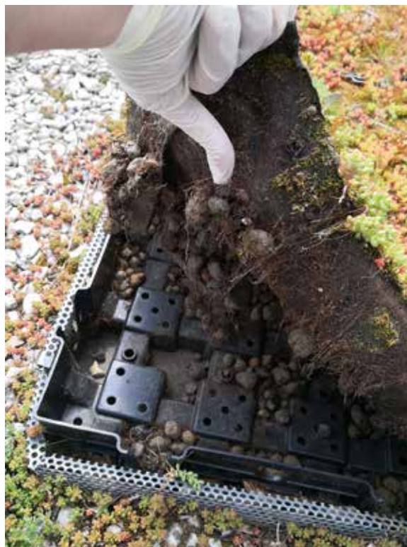
Certains systèmes de végétalisation se dégradent et peuvent laisser des traces. S'affranchir du plastique est plus que jamais essentiel dans la conception des toitures végétalisées © Marc Barra | ARB îdF
